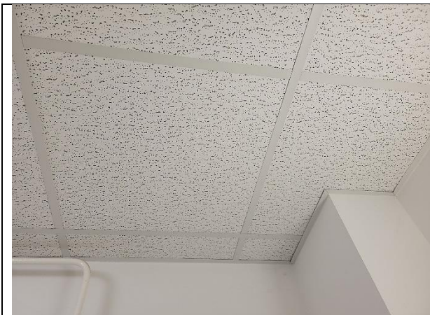
Leitstelle, WC, Deckenplatten (KMF)
