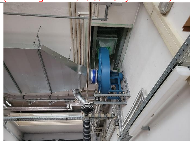
Abluftanlagen in den Fahrzeughallen
