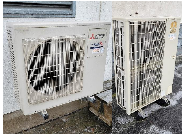
2x Klimaanlagen / Wärmepumpen neben und auf der Leitstelle (Kältemittel)
