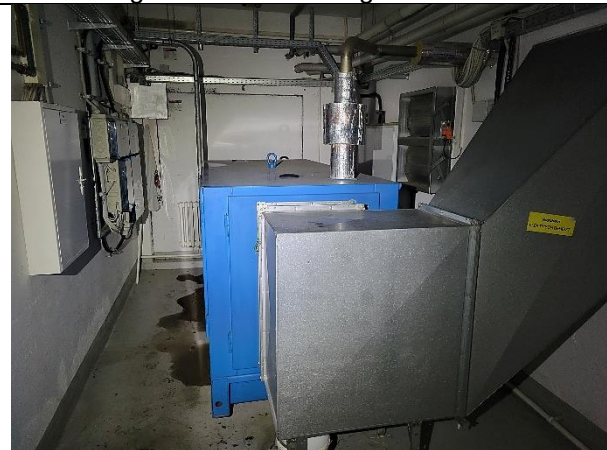
Notstromaggregat in der Leitstelle, Baujahr Januar 1993, 25 kVA (potenziell Öl- und Kraftstoffreste, Bleibatterien)
