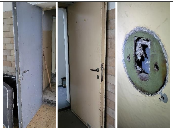
Brandschutztüren mit Asbestfüllung (schwachgebunden, 20-50% Chrysotilasbest) P1
