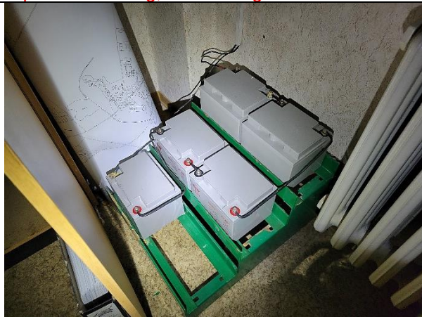
Bleibatterien in der Leitstelle
